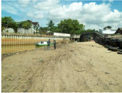
Sungai Klandasan Besar / S. Ampal Sepinggangan Sebagai Saluran Primer Drainase
